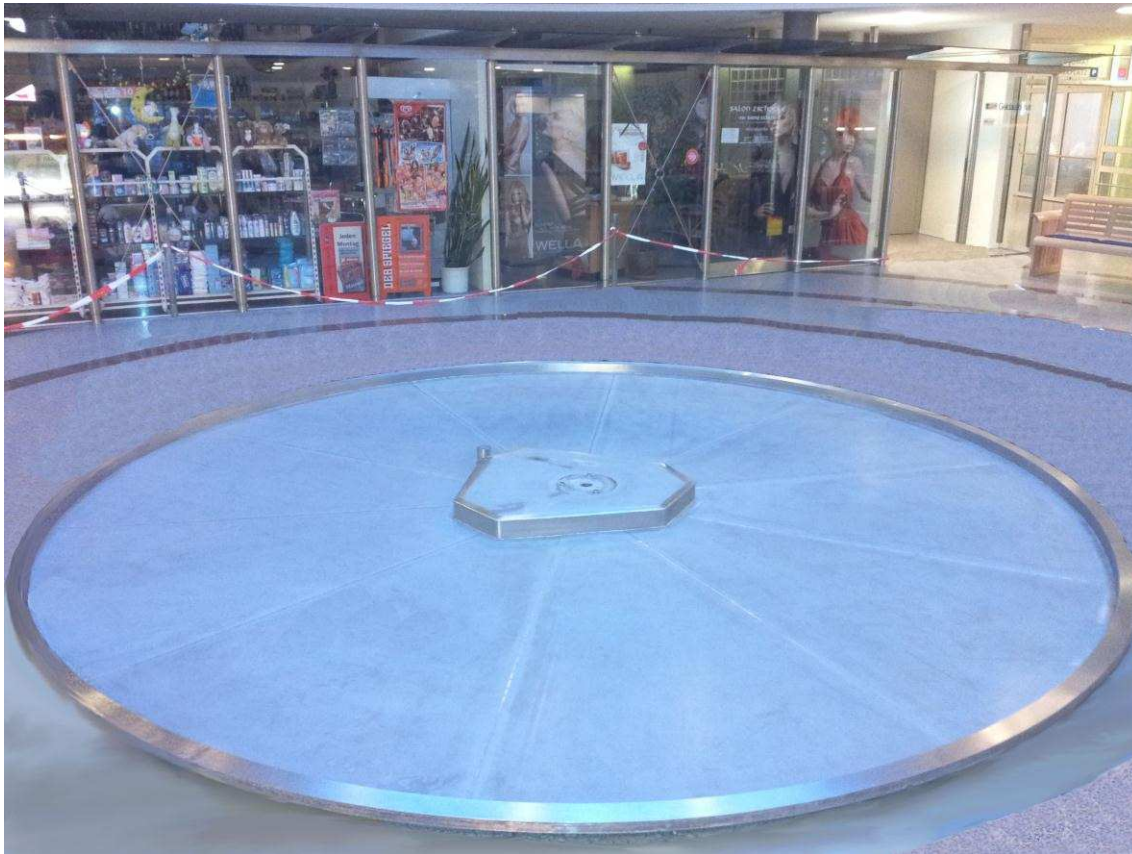
Brunnenauskleidung als wasserdichte Wanne im Krankenhaus Hartmannsdorf (Lining of a fountain as watertight basin in the hospital in Hartmannsdorf)
